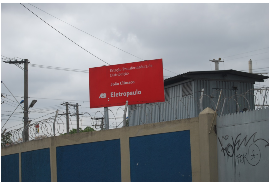
Foto 11– Rua Barão de Mauá – Estação Transformadora da Eletropaulo.
