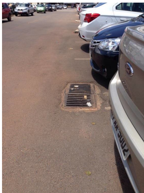
Figura 23: Boca de Lobo Frente ao Empreendimento Fonte: Master Ambiental (2017)
