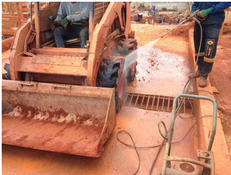
Figura 51: Sistema de Lavagem de Equipamentos. Fonte: Master Ambiental, 2017
