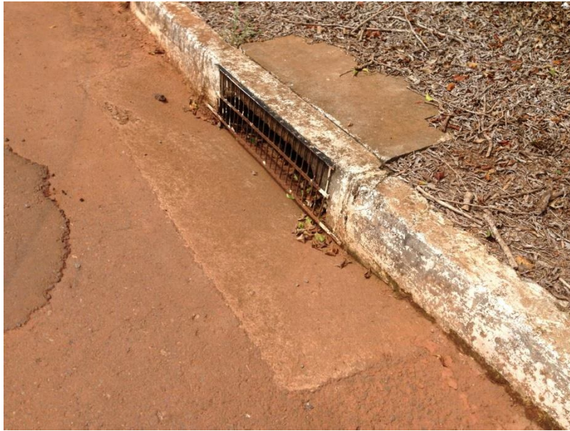
Figura 52: Galeria com grade próxima ao empreendimento. Fonte: Master Ambiental, 2017
