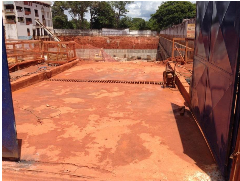
Figura 50: Sistema de Lavagem de Equipamentos. Fonte: Master Ambiental, 2017
