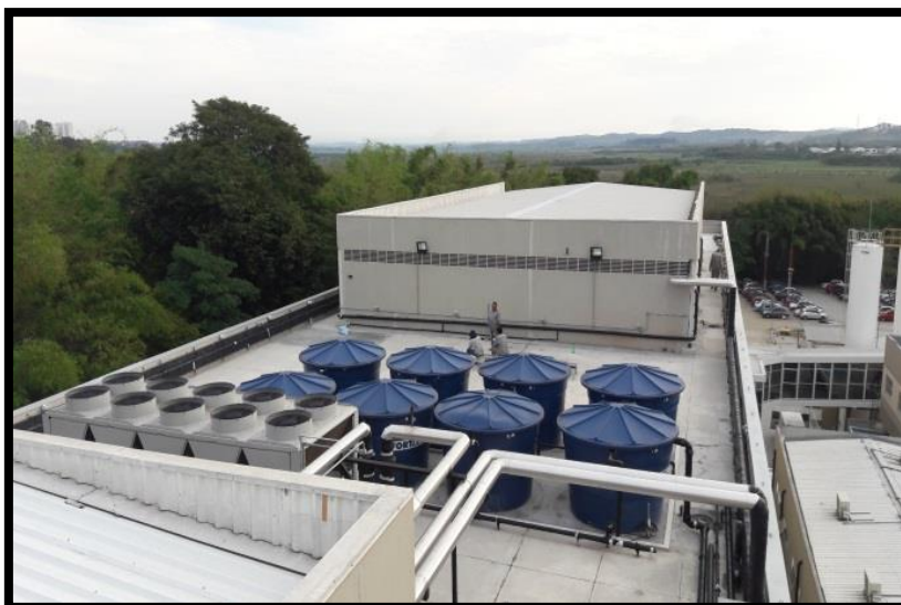
Reservatórios / Caixas D'águas
